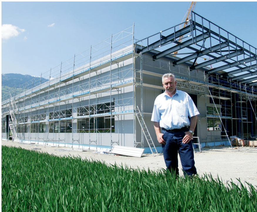
Keller Laser in Trimmis.
